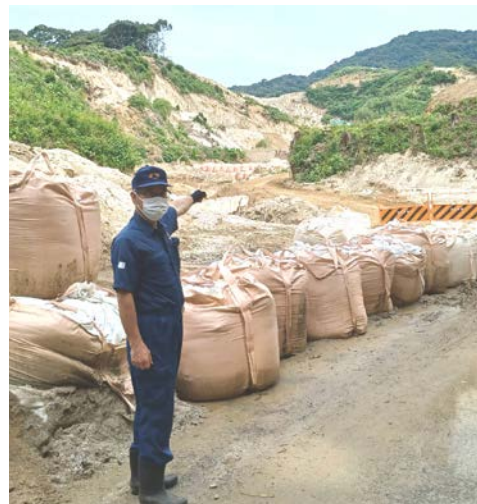
南関町の土砂崩落現場を調査(9月12日)
