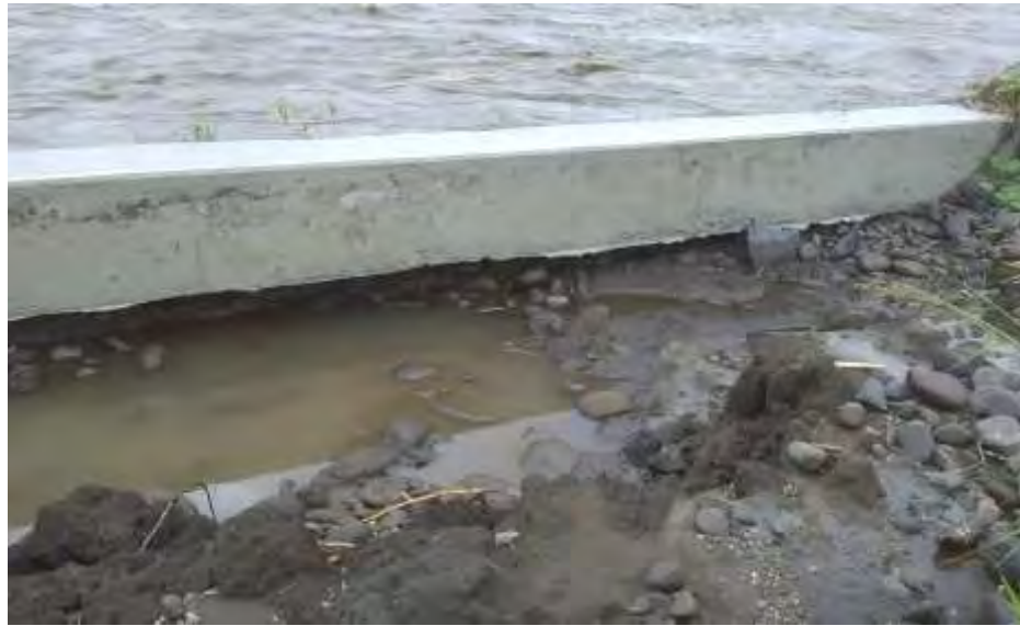
白川中流域の護岸箇所。河川からの越流が内側から土砂をえぐり、コンクリート堤防の下部がぼっかり空いた状況となっています。
