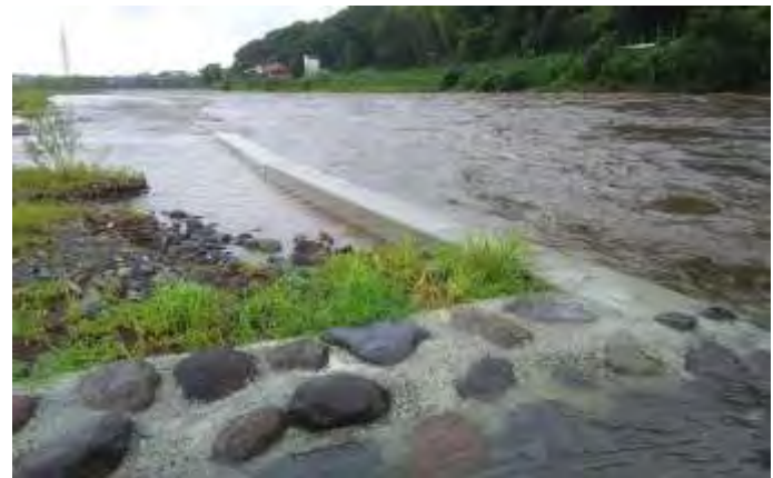
コンクリートの護岸工事部分が壊れ(写真左上)、岸の部分に河川からの越水が流れ込んでいます。
