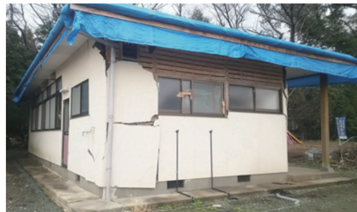
建物や地盤に大きな被害を受けた大津町の地域集会所。再建への苦悩が続いています。
