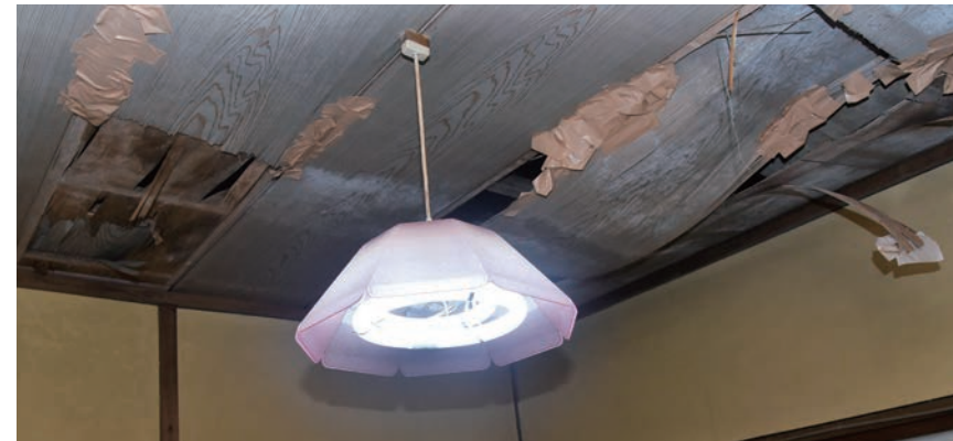
一部損壊と判定された熊本市のAさん宅。雨漏りが続き天井の板がはがれていますが修理できずにいます。
