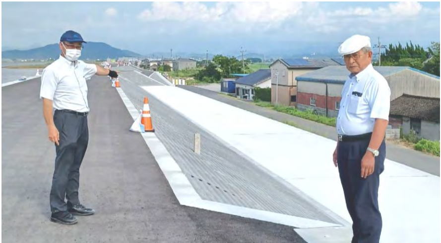
緑川の工事現場を視察する山本のぶひろ県議（左）と福田慧一宇土市議
