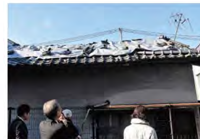
一部損壊家屋の被災状況を調査
