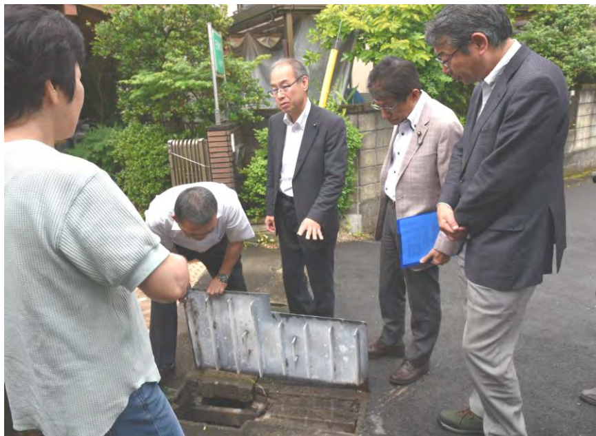
側溝の排水が流れず家の玄関前で悪臭が発生していました(甲佐町芝原)
