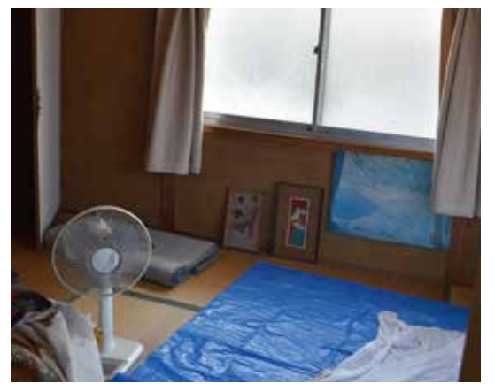
一部損壊と判定された熊本市Bさん宅。雨漏りのため畳にビニールシートが。
