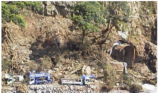
地震後のダム予定地・仮排水路付近の状況。土砂崩れで工事車両が埋まっています。
