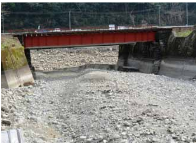
堆積した土砂
